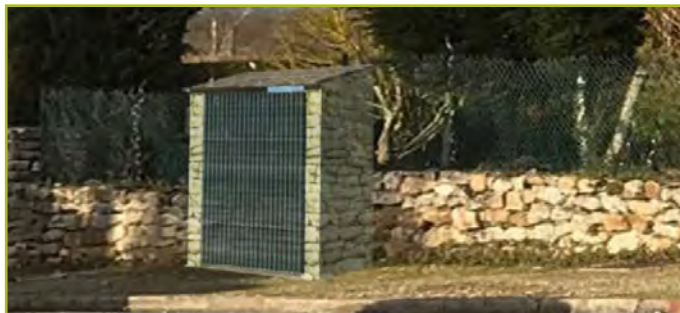
Projet d'intégration d'une armoire lors du développement de la couverture « fibre »
